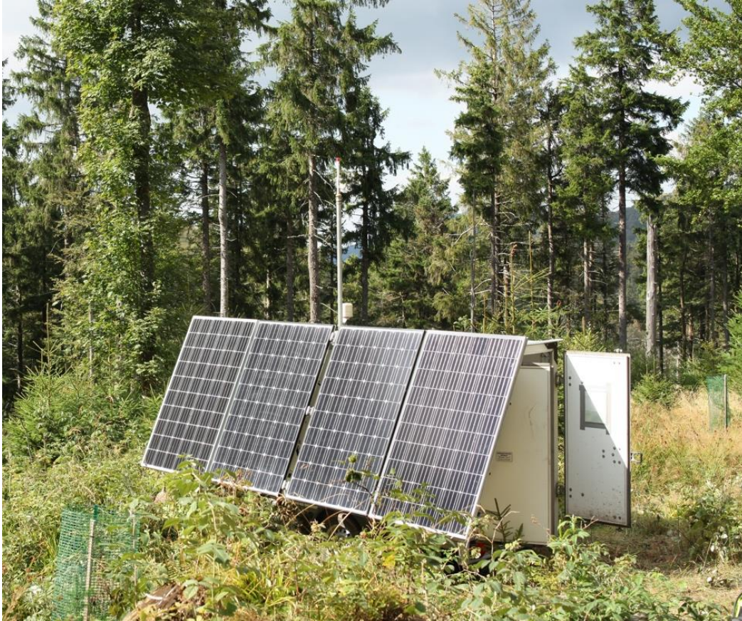
Foto: Lidar Gerät in Anhänger mit Solarpanels zur Stromversorgung.
